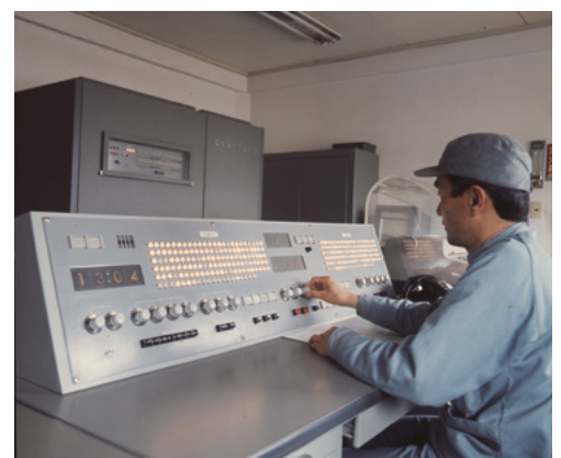
Автоматическая камера для сушки древесины с компьютерным управлением на фабрике Тенрю компании Yamaha (1956)
